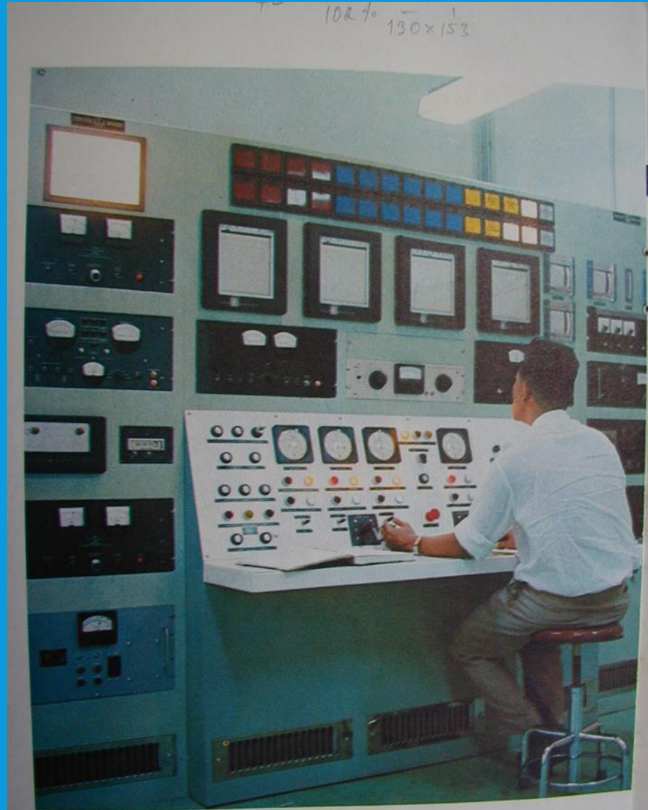
ภาพถ่ายในห้องควบคุมเครื่องปฏิกรณ์ปรมาณู หน้าปัดต่างๆ เหล่านี้ จะแจ้งความเคลื่อนไหวของเครื่องปฏิกรณ์ปรมาณูในทันที
