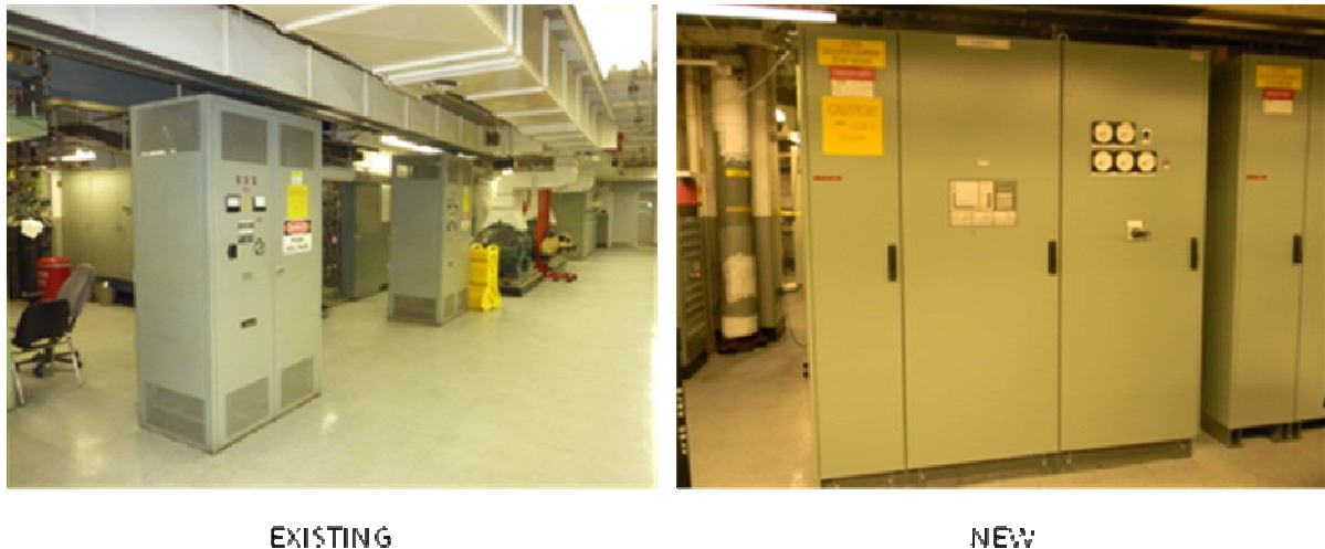
Fig 10. NRU Class I Rectifiers
